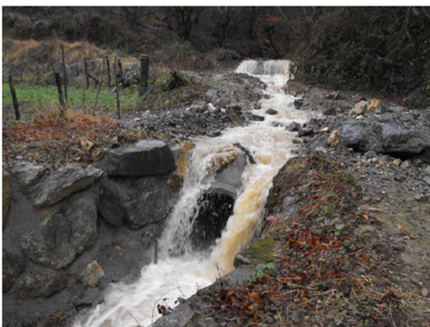
Désordres constatés sur le chemin de Soudious suite au colmatage de la canalisation par les matériaux issus du versant – post-crise de janvier 2014
