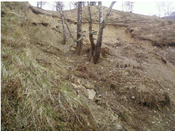
Glissement constaté sur le bassin du Jouers post-crise de janvier 2014
