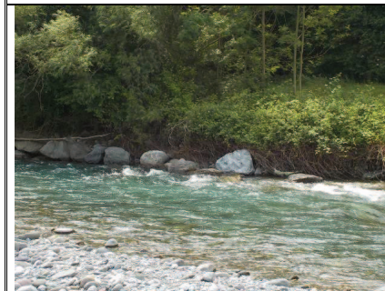
Le Gave à Lées Athas, dégradation sur protection de berge de la canalisation d'assainissement
