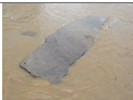
Importante dégradation du revêtement routier devant la SMO
