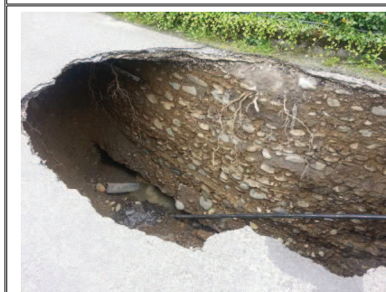
L'Arroder à Navarrenx, effondrement de voirie par sous cavement
