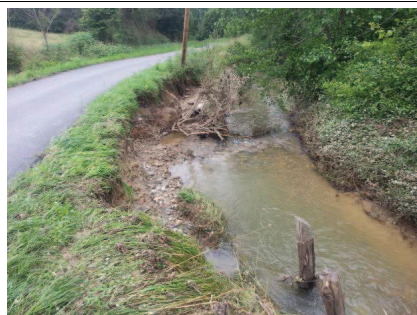
Le Laüs à Ogenne Camptort, destruction d'une partie de la protection de berge réalisée en 2016
