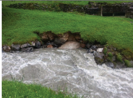
Le Sadun à Etsaut, érosion de berge face au local communal
