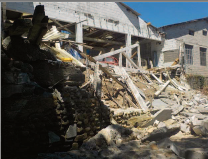
Le Laüs à Navarrenx, effondrement des établissements Lançalot
