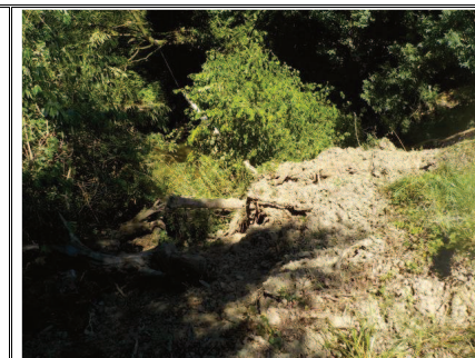
Le Laüs à Navarrenx, effondrement de berge et chablis dans le lit du cours d'eau en amont de la station de captage
