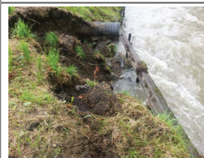
Le Vert d'Arette à Aramits, effondrement de berge au droit du terrain de pétanque
