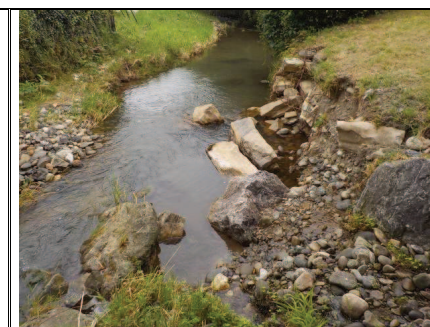
Les Barthes à Audaux, érosion en amont de la passerelle
