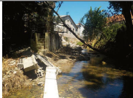
Le Laüs à Navarrenx, effondrement des établissements Lançalot
