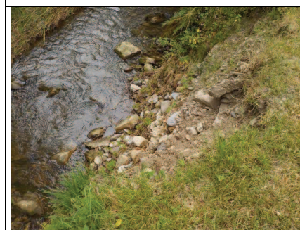
Les Barthes à Audaux, érosion de berge au droit de l'école
